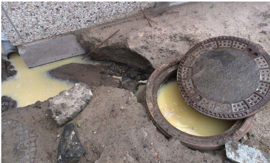
Foto: Verzakking in het rioleringssysteem.
