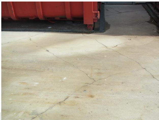
Foto: Voorbeeld niet-vloeistofdichte voorziening (scheuren).
